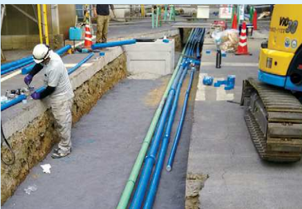
工場埋設消火配管
